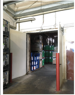
Eines der neuen Brandschutz Tore
